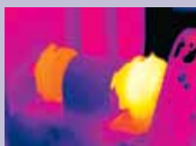
Перегрев крышки подшипника
