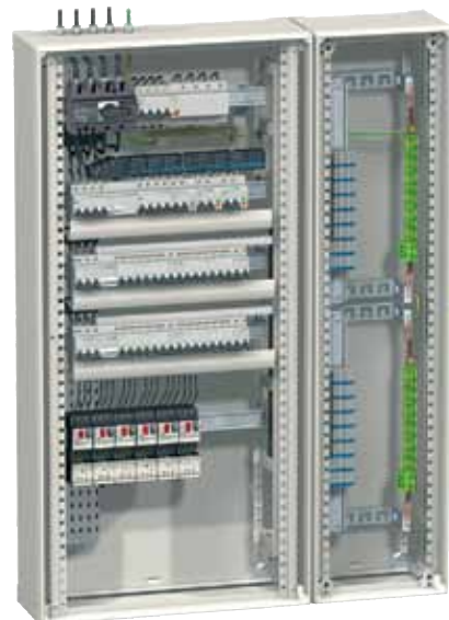
Вводной аппарат в силовом распределительном щите Prisma
