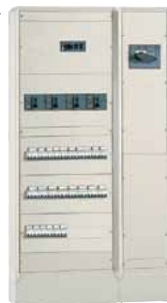
Промежуточный распределительный ЩИТ
