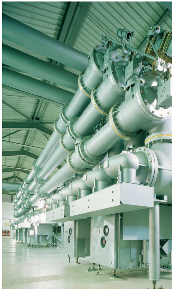
В системах высокого и среднего напряжения SF 6 используется во избежание разрядов. testo 6740 выполняет непрерывный мониторинг влажности, поддерживая диэлектрическую прочность дорогостоящего газа и позволяя избежать повреждений.
